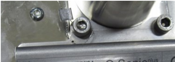
Abbildung 5-10: Plombe des Hauptschilds
